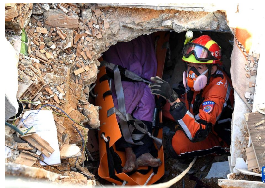
2月9日,中国救援队队员在土耳其哈塔伊省安塔基亚市的受损建筑上开展救援工作。
